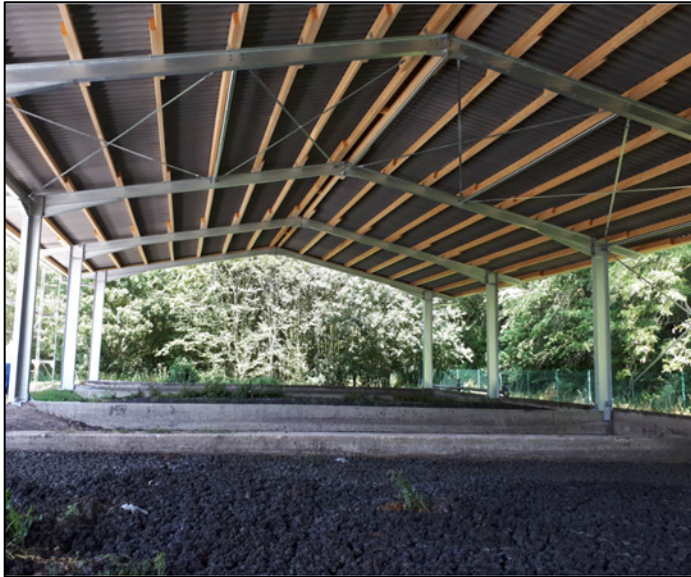
Abbildung 56: Trockenbeete mit Überdachung in Rasdorf
