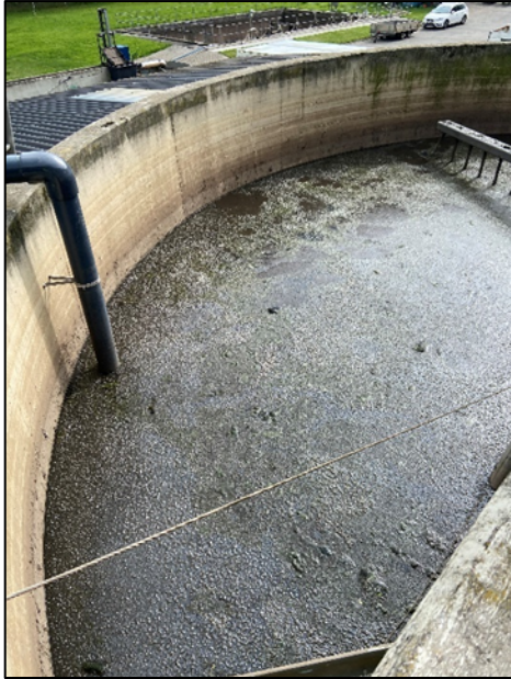
Abbildung 9: Blick in einen statischen Eindicker im Betrieb
