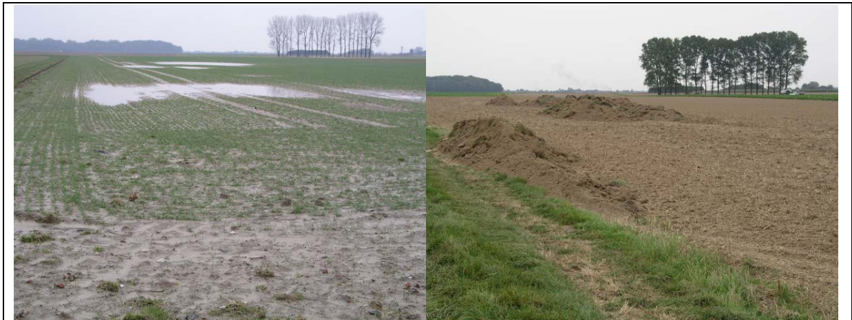
Abb. 10–3: Links: Pfützenbildung in Sackungsbereichen (Ingenieurbüro Feldwisch) Rechts: Auffüllen der Sackungen mit geeignetem Bodenmaterial bei trockenen Bodenverhältnissen (Ingenieurbüro Feldwisch)
